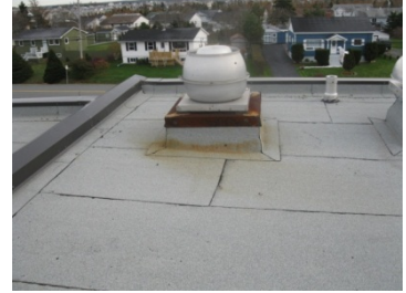
4.6.24 | Kitchen exhaust fan
